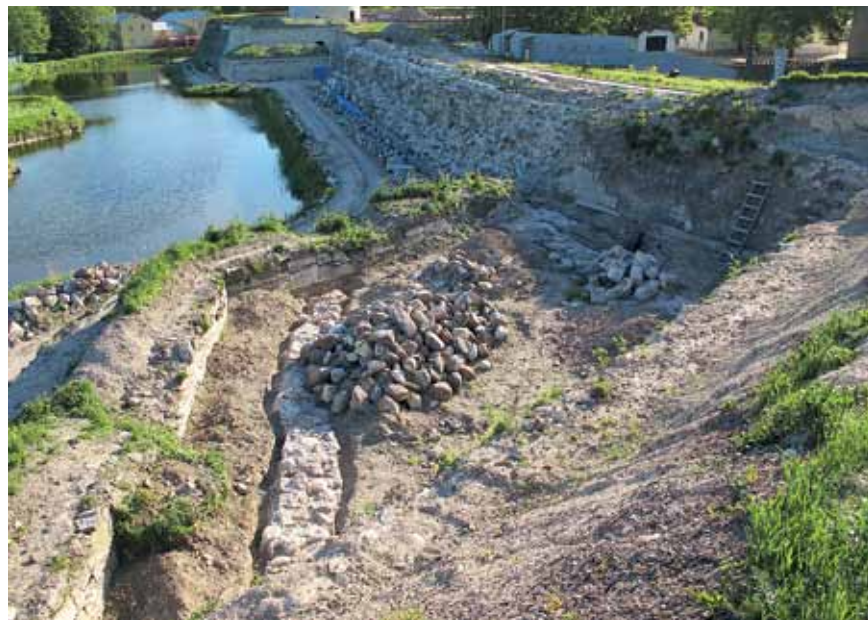
III. 118. Läänebastioni alumine põhjaflank vaatega põhjabastioni suunast. Hästi on näha taaniaegse bastioni parempoolse fassi eskarpmüüri asend, mis on hilisemast eskarpmüürist tunduvalt seespool. Tegemist on siiski müüri asendiga üksnes antud kõrgusel. Varasema eskarbi kalde tõttu oli erinevus madalamal tõenäoliselt väiksem. Foto: G. Püüa
